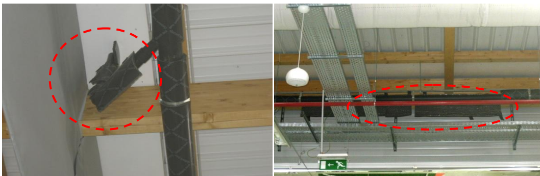
Figura 6-5: Descolamento da proteção acústica da rede geberit-pluvia
