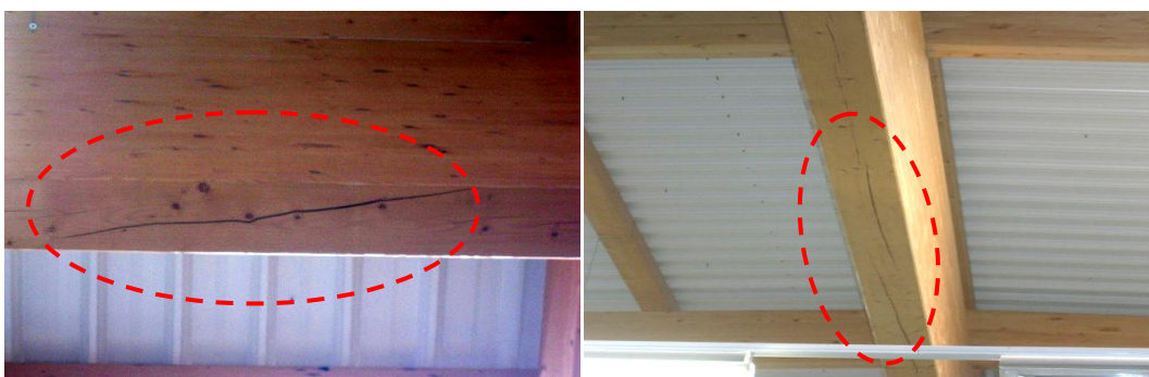
Figura 6-2: Fendas na viga V1 da estrutura da cobertura
