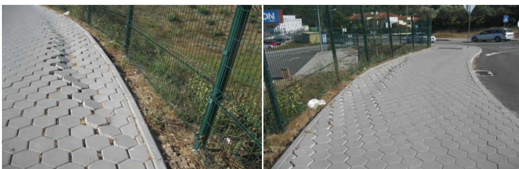
Figura 6-7: Abatimento da camada do pavimento suporte do pavê nos passeios exteriores
