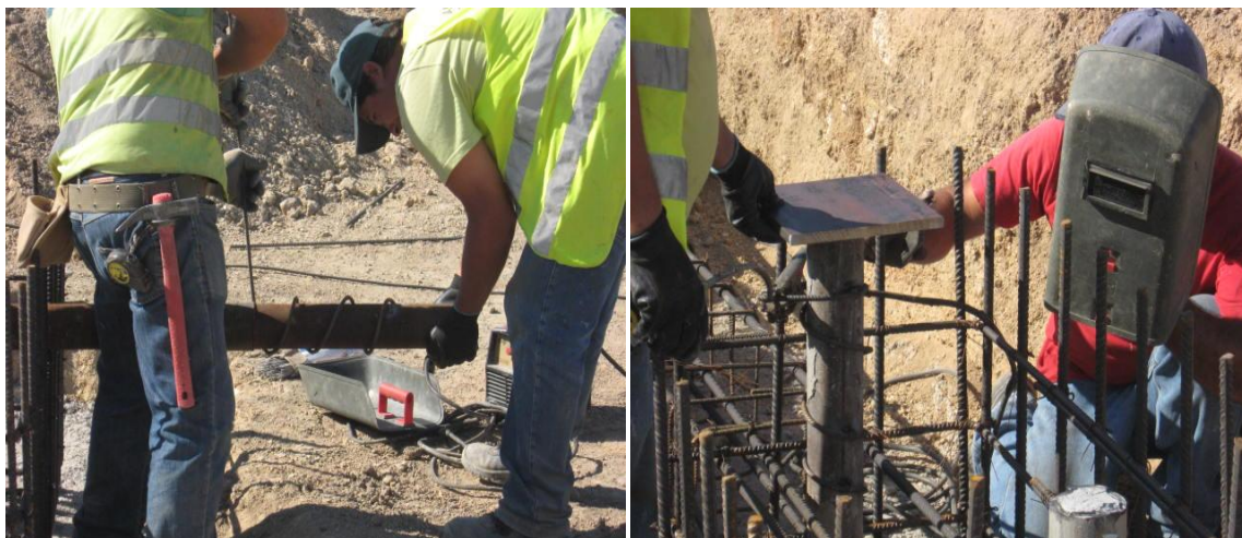
a) Solução para melhorar a aderência do betão à microestaca – ferro de 6 dobrado e soldado
