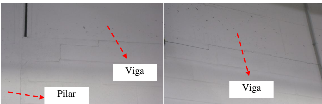
Figura 6-4: Fissuras nas paredes interiores de alvenaria de bloco de cimento na separação entre a zona comercial e a zona de serviços
