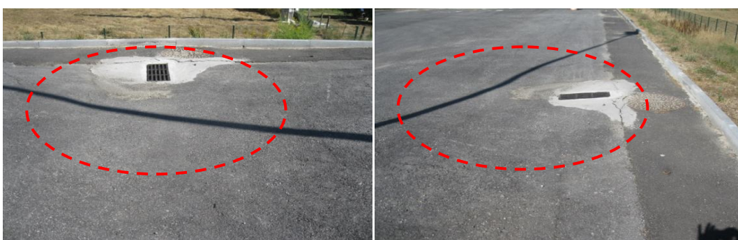
Figura 6-6: Abatimento do pavimento junto ao talude da zona de cargas e descargas
