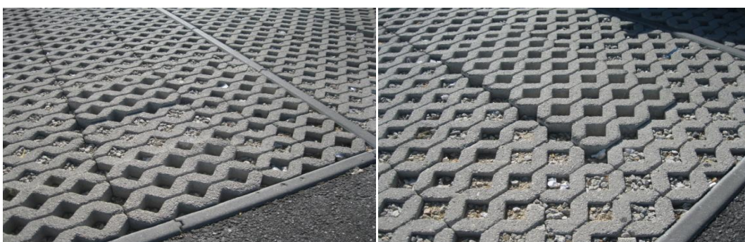
Figura 6-8: Abatimento da camada do pavimento suporte de grelhas de enlramento do estacionamento
