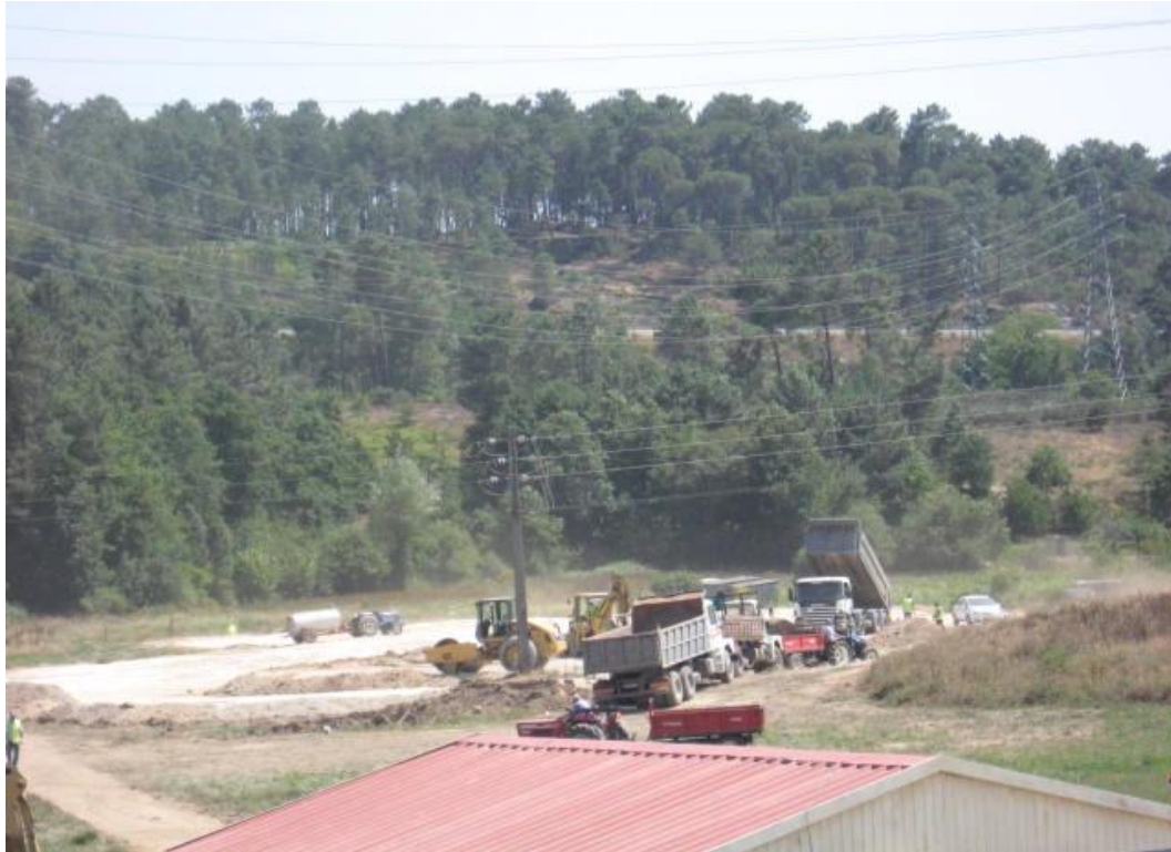
Fig. 1 – Movimentação de terras – escavação e transporte de terra preta; compactação de plataforma com saibro.
