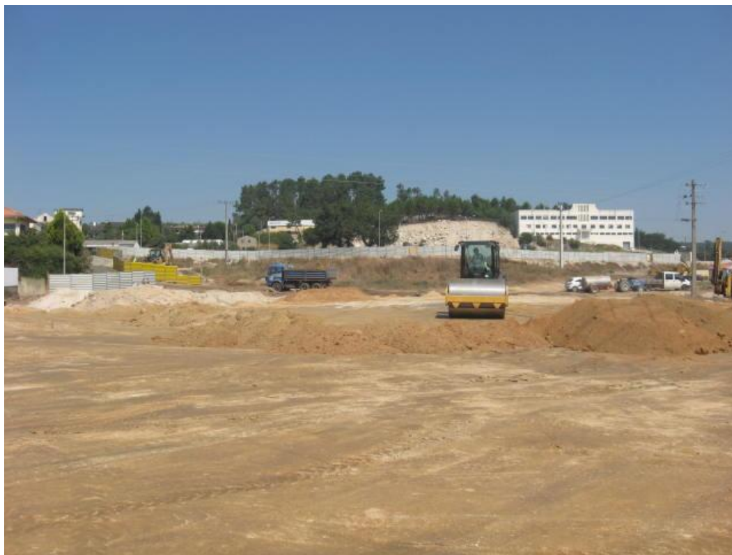
Fig. 14 – Movimentação de terras: colocação e compactação de saibro na 2ª camada (rectificada).
