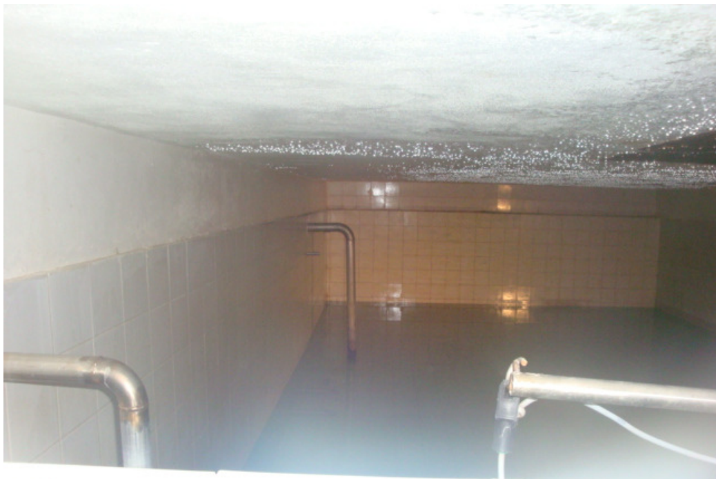
Figura 18 – Visualização do tanque de armazenamento da água de arrefecimento.
