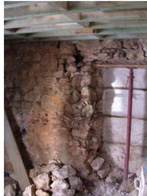
Figura 21 - Desagregação de alvenaria devido a infiltrações de água (Farinha, 2008)
