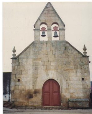
Figura 22 - Humidade ascensional em estrutura de alvenaria (NCREP, 2011)
