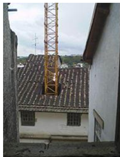
Figura 26 - Restrição no equipamento de elevação de cargas
