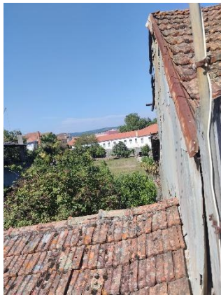
a) Telhas desalinhadas
