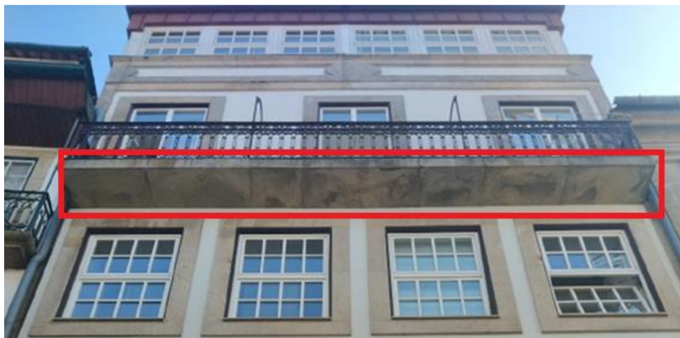
Figura 43: Fachada do edifício PT3 com indicação das anomalias
