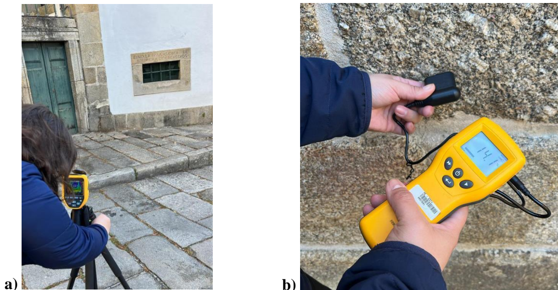
Figura 28: Capela de Nossa Senhora dos Remédios a) Imagem termográfica na parede P3; b) Leitura com o humidímetro na parede P2
