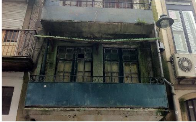
Figura 3: Fachada com amplas anomalias na Rua do Comércio do Porto (MOREIRA, 2016)
