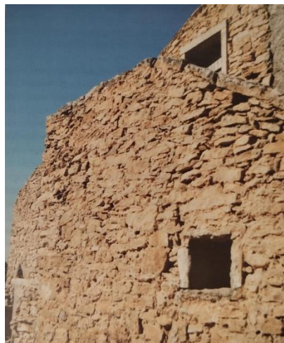
Figura 2: Alvenaria de pedra seca ou mal agregada (APPLETON, 2003)
