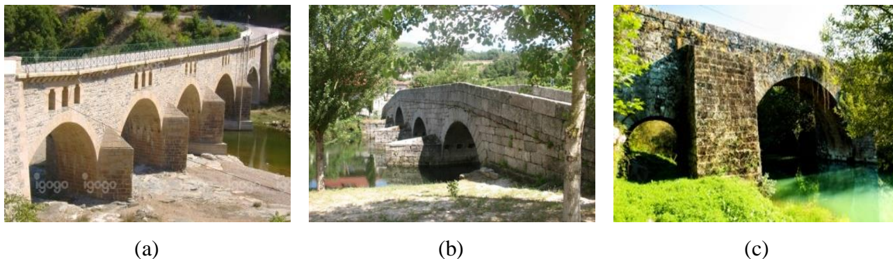
Figura 2-11: Talha-mar triangular da ponte de: (a) Mogadouro. (extraída de Igogo); (b) Amarante. (extraída de Informática). (c) Talhante retangular da ponte de Amares. (extraída de Município Amares)
