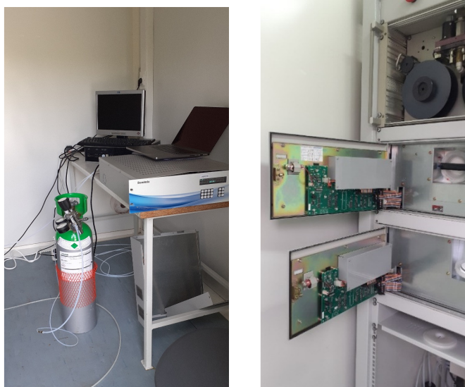
Figura 65 - Manutenção e calibração dos analisadores e equipamentos existentes no interior e exterior da EMQA.
