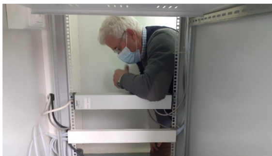
Figura 62 - Verificação do estado da UPS
