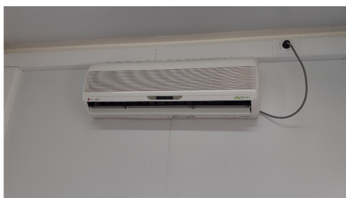
Figura 64 - Sistema de ar condicionado existente no interior da EMQA
