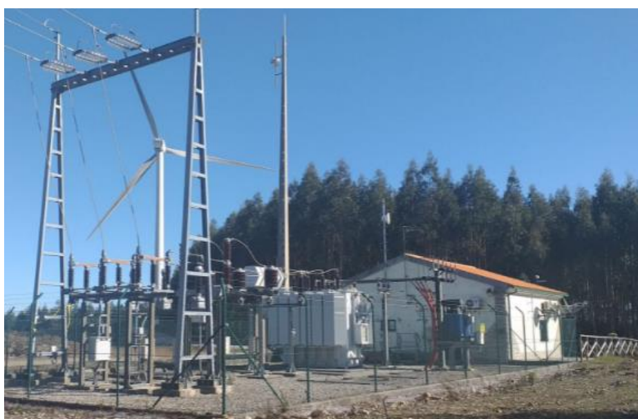
Figura 18 - Subestação parte intempérie
