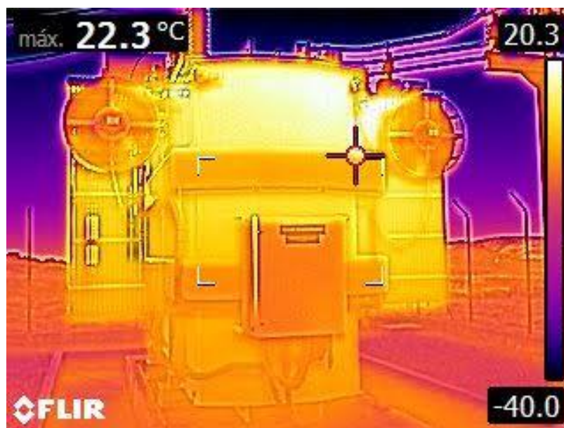
Figura 46 - Termografia ao transformador da subestação
