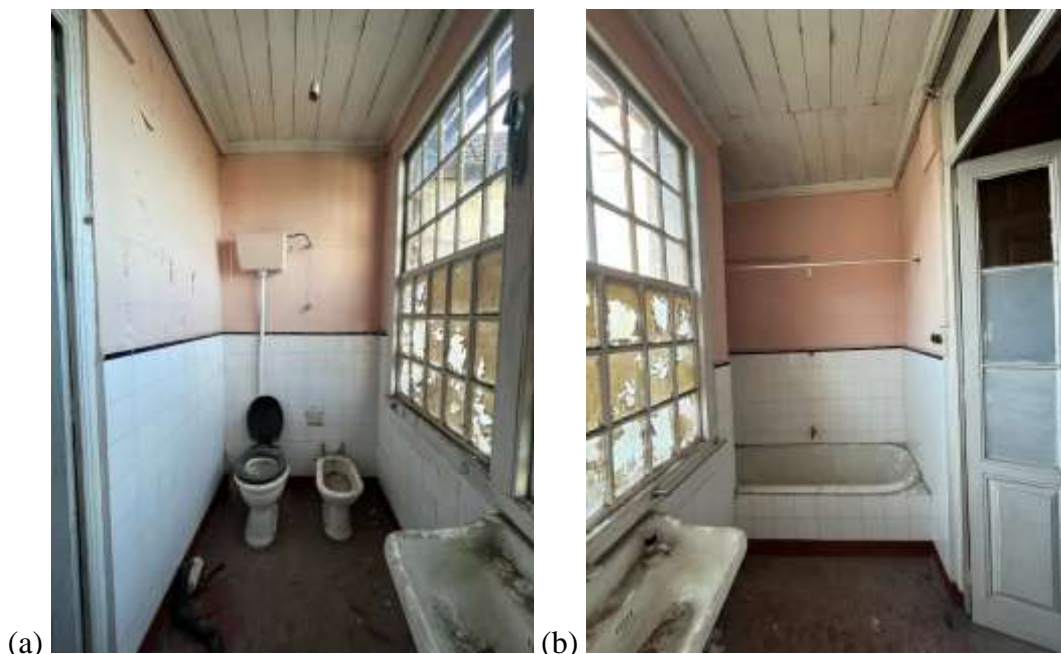
Figura 12 - Instalações sanitárias da varanda envidraçada localizada no piso 2.
