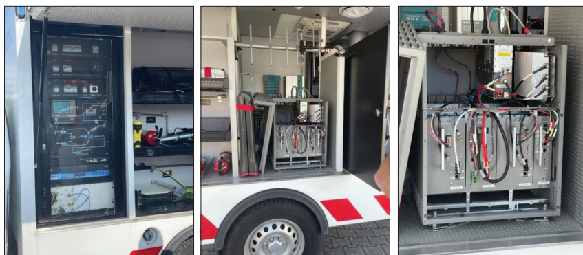
Fot. 3 - Estação Movel Ligeira, unidades de alimentação e comunicação (Fotografia de Márcio Teles, tirada a 24/05/2023).
