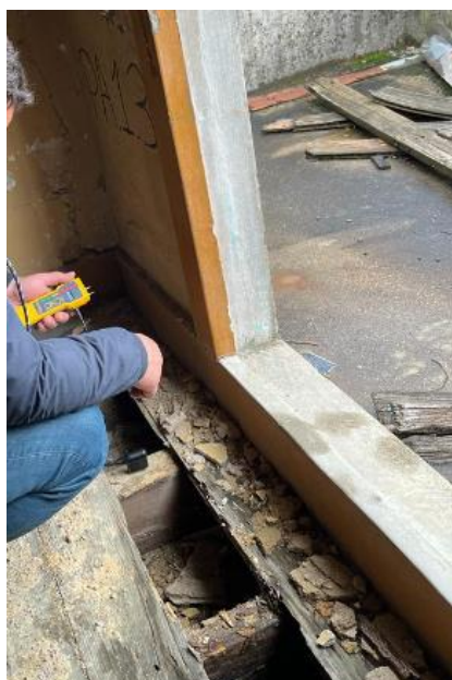
Figura 56: Zona de transição no piso 3 entre os pavimentos de madeira (interior) e de betão (exterior)
