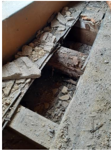
Figura 62: Viga do pavimento do piso 3 exposta à humidade
