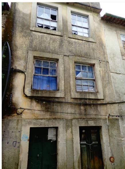
Figura 65: Exemplo de sujidade ao longo da fachada do alçado principal
