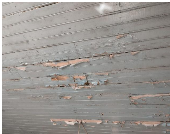
Figura 64: Destacamento de tinta do teto do pavimento do piso 2
