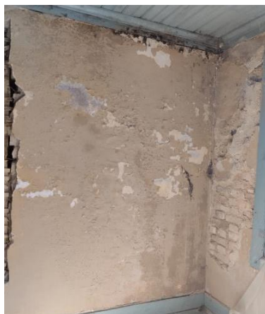
a) Manchas de humidade
