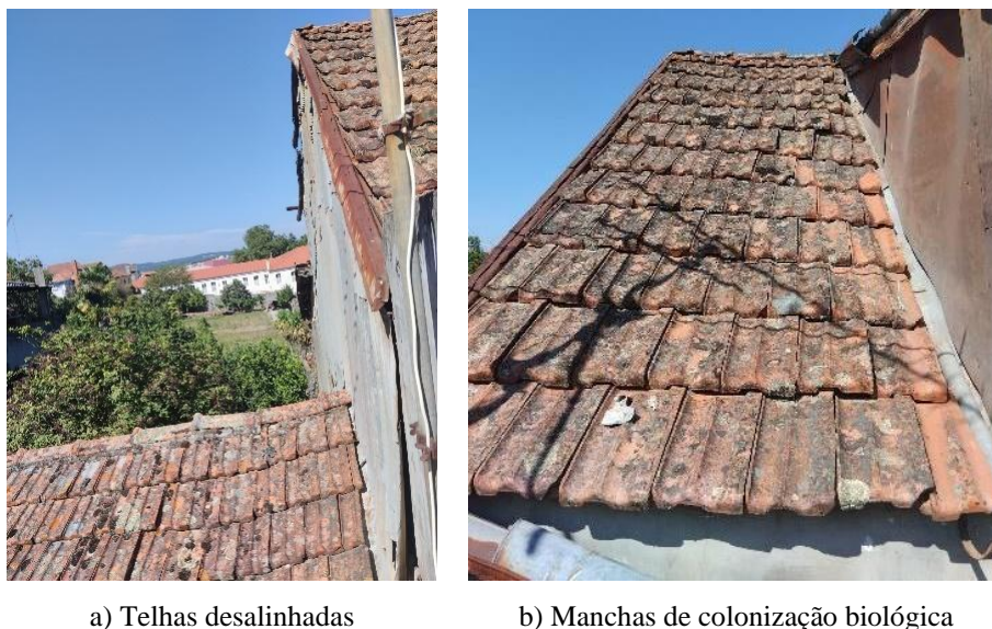
Figura 70: Exemplo de danos existentes na cobertura
