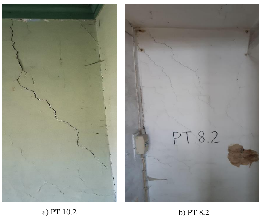
Figura 60: Exemplos de fendilhação estrutural
