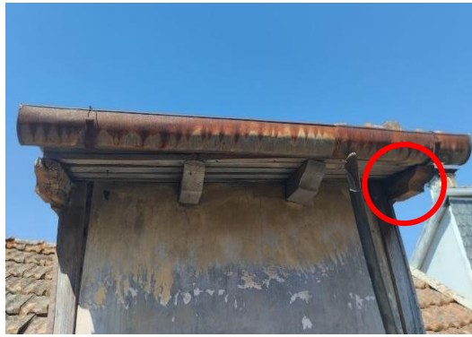
a) Caleiro em estado de corrosão e tubo de queda sem encaixe
