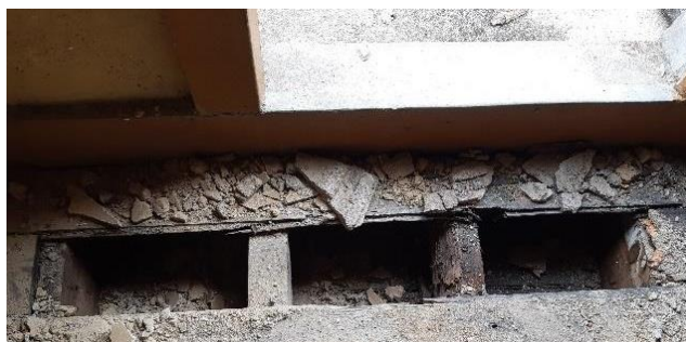
Figura 97: Vigas com maior valor de humidímetro – R_PAV 3.3
