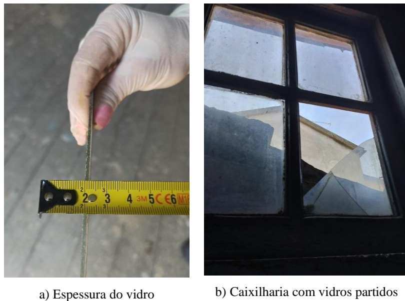
Figura 68: Vidros partidos - caixilharias
