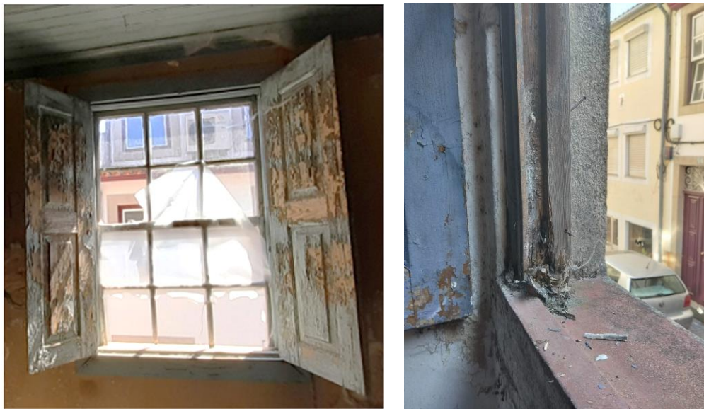
a) Caixilharia com pintura desgastada
