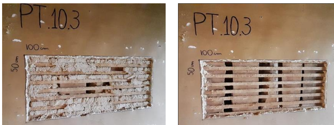
a) Exemplo de PT com argamassa de preenchimento b) Exemplo de PT sem argamassa de preenchimento
