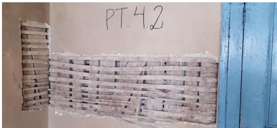
Figura 39: Parede de tabique PT 4.2 no encontro com parede exterior em tabique com diagonal
