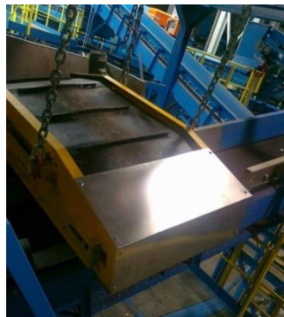
Figura 6-13 Separador eletromagnético do Centro de Tratamento Mecânico de RSU.
