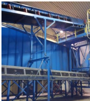
Figura 6-14 Piso móvel do Centro de Tratamento Mecânico de RSU.
