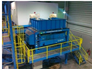
Figura 6-11 Abre sacos – Terminator do Centro de Tratamento Mecânico de RSU.
