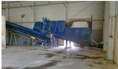
Figura 6-4 Tremonha de Descarga do Centro de Tratamento Mecânico de RSU.
