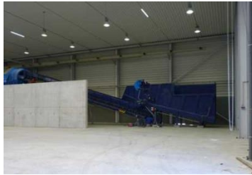
Figura 6-8 Tremonha de descarga do Centro de Tratamento Mecânico de RSU.
