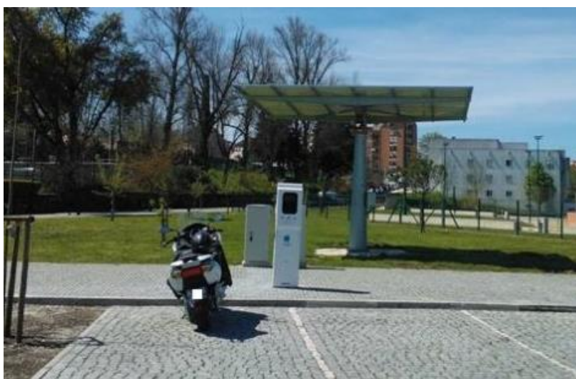
Figura 6 - Posto de carregamento Mobi.e em Viséu
