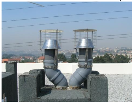
Ventilador estático na conduta da instalação sanitária
