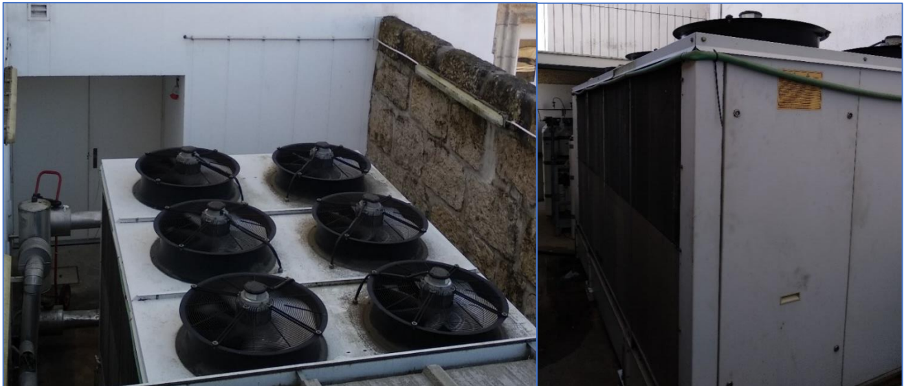
Figura 17 - Aspeto da zona técnica exterior – Chiller
