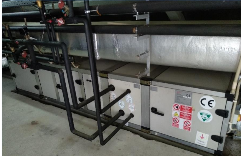
Figura 23 - Zona técnica sótão - UTA
