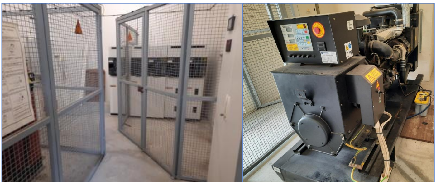
Figura 18 - Posto de transformação (PT) e grupo gerador elétrico
