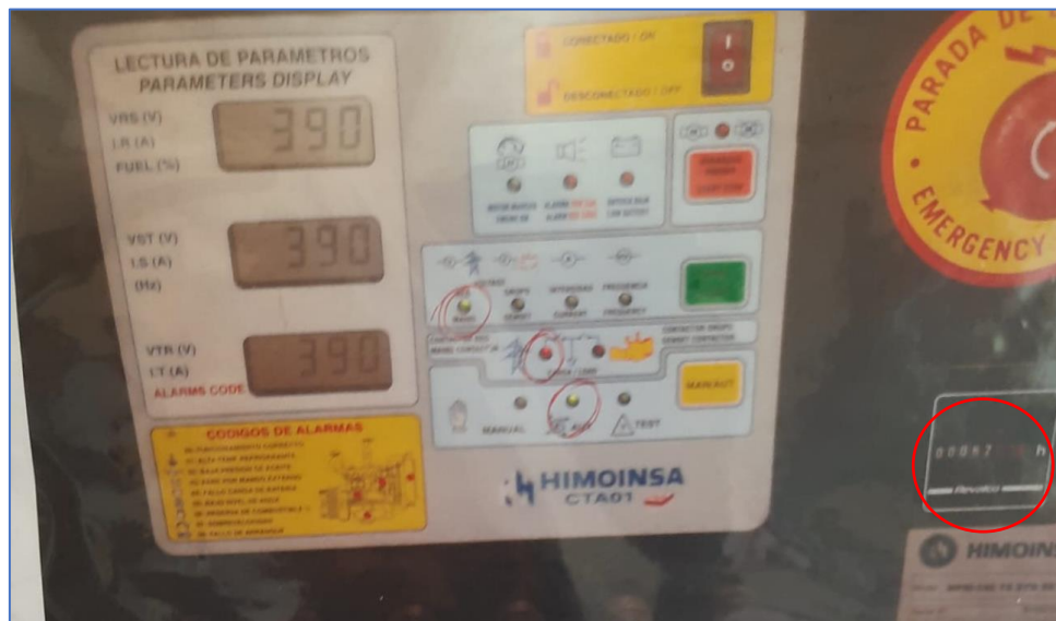
Figura 55 – Display - Grupo gerador elétrico
