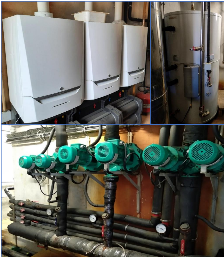
Figura 16 - Aspeto da zona técnica interior – Sistema de produção, bombagem e acumulação de AQS
