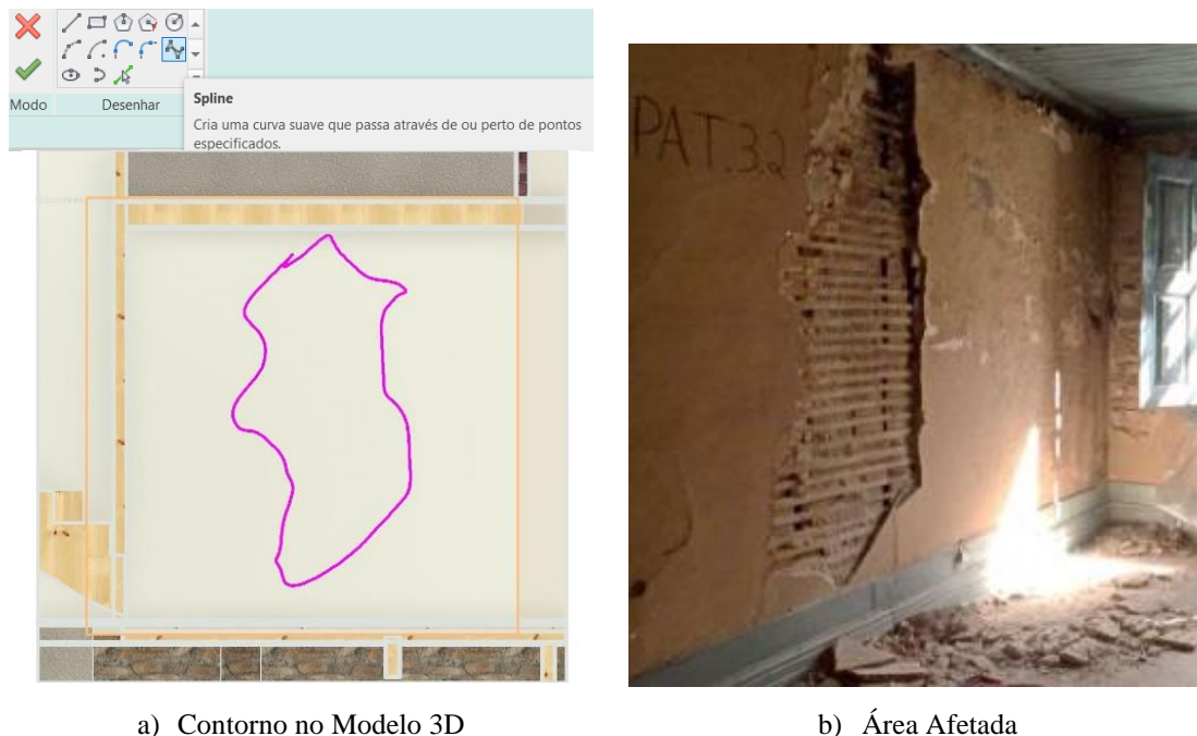
Figura 71 - Mapa de dano do destacamento da argamassa na PT 3.2
