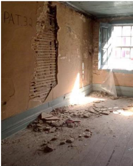
a) Destacamento do reboco
