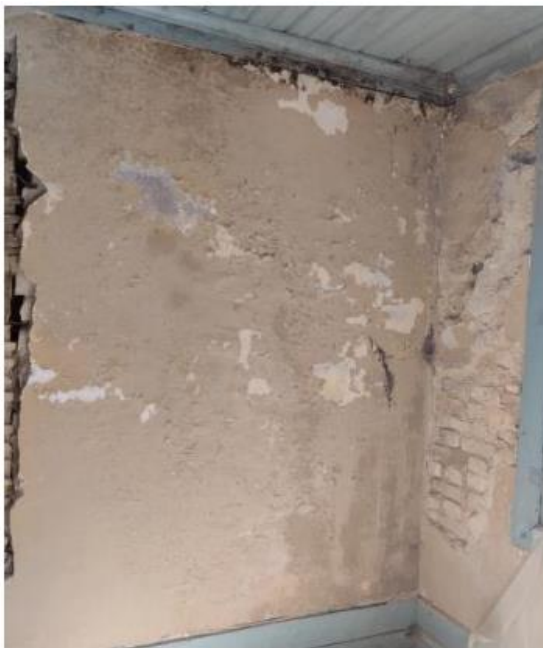
c) Manchas de humidade
