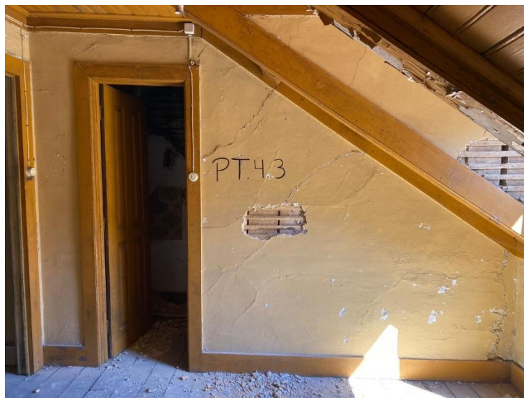
Figura 22 - Parede com fendilhões e fissurações (Mendonça, 2023)
