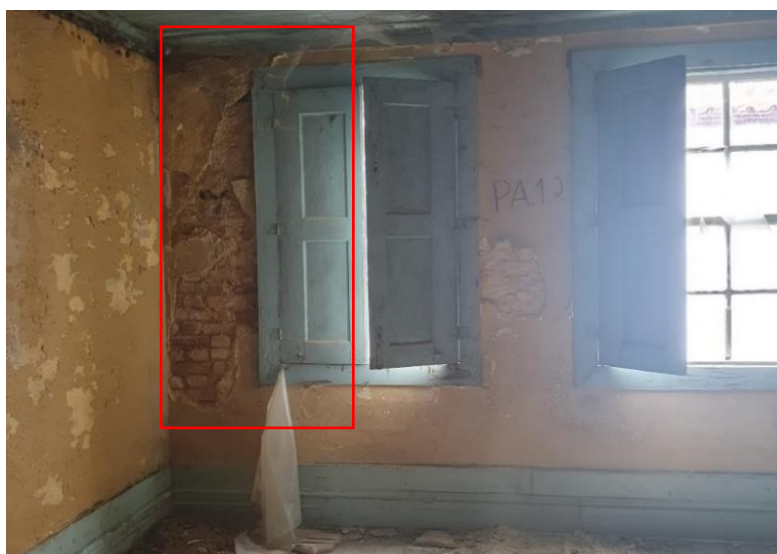
Figura 24 - Vista interior da parede de tijolo maciço com argamassa de terra e cal do piso 2
