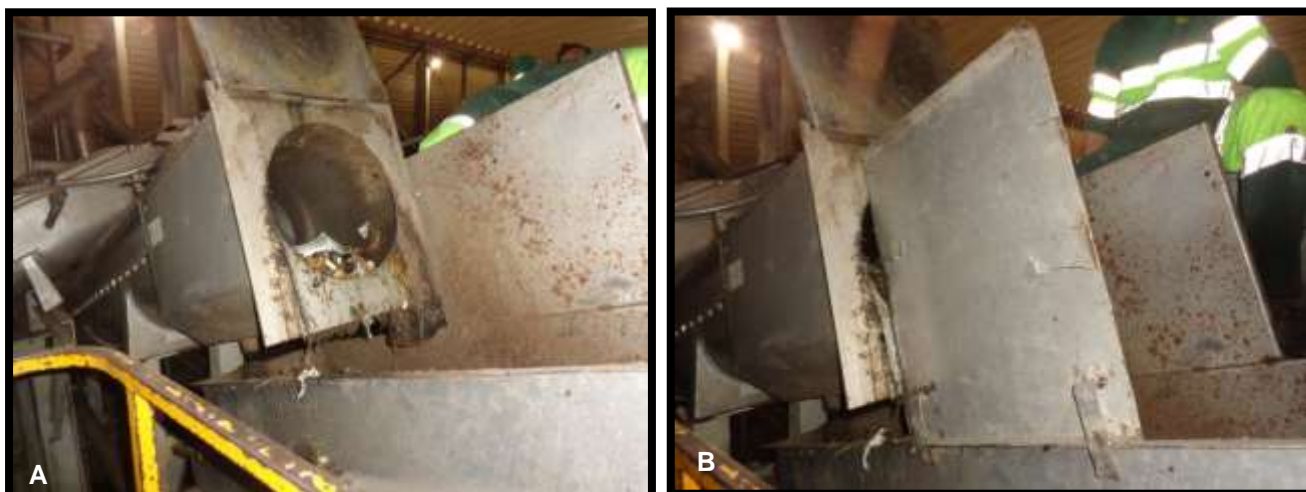
Figura 7-15 – Alterações da estrutura no local de recolha dos pesados do crivo rotativo húmido
