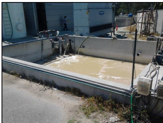
Figura IV.3.4. Tanque de bombagem de 70 m 3 .
