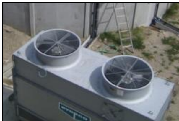
Figura IV.3.3. Torre de refrigeração.
