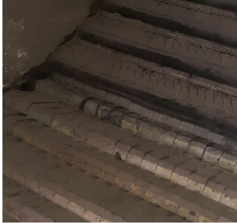
Figura 10 - Grelhas da câmara de combustão (Luso Finsa 2023)
