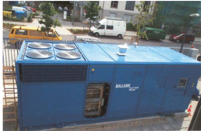
Figura 3.14 – Pilha de Células de Combustível com Membrana de troca de Protões de 250 kW (eléctricos) da Ballard Power Systems instalada na cidade de Berlin em 2000.
