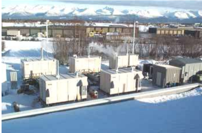
Figura 3.29 – Cinco unidades de Pilhas de combustível PC 25™, do Centro de Processamento dos Correios do Alaska.
